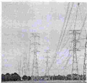
Đường dây 500kV Pleiku - Mỹ Phước - Cầu Bông
