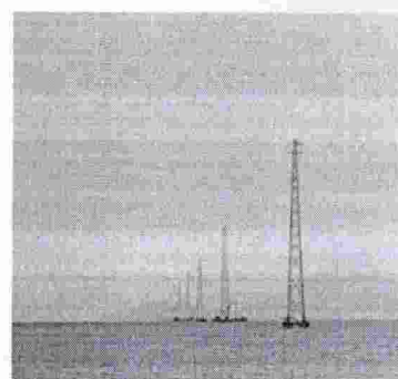
Đường dây 22kV vượt biển ra đảo Hòn Tre, huyện Kiên Hải
