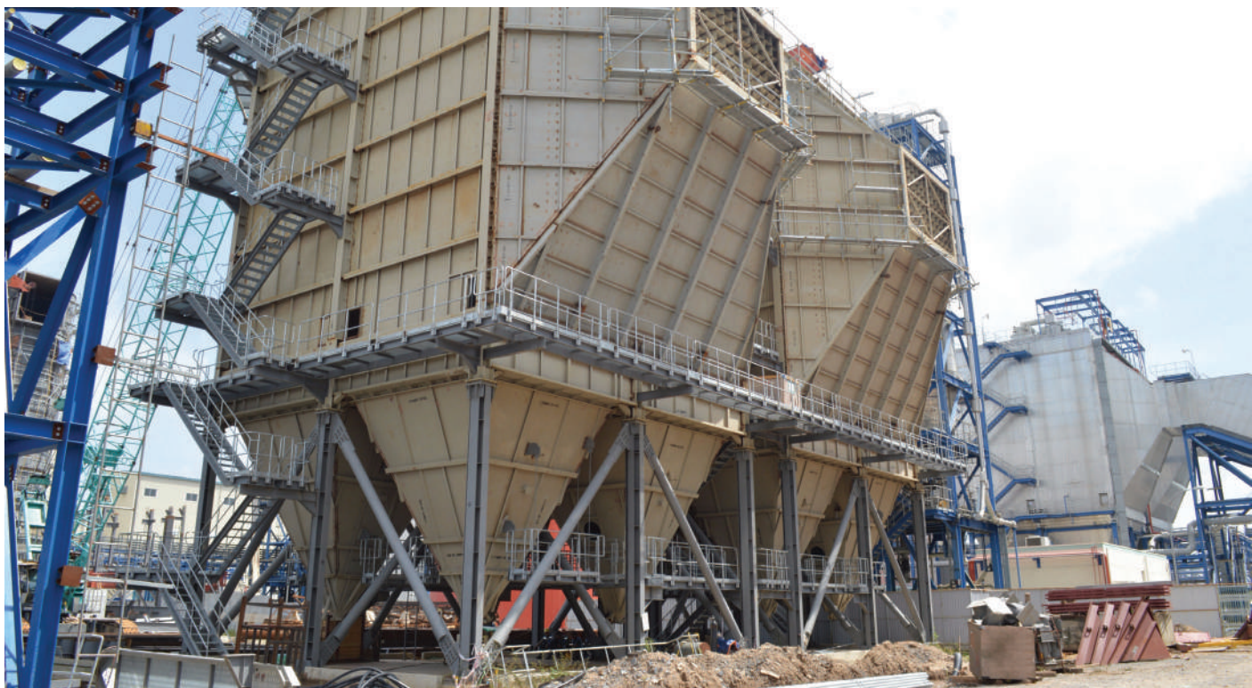
Hệ thống lọc bụi tĩnh điện ESP tại NM Nhiệt điện Vĩnh Tân 4
